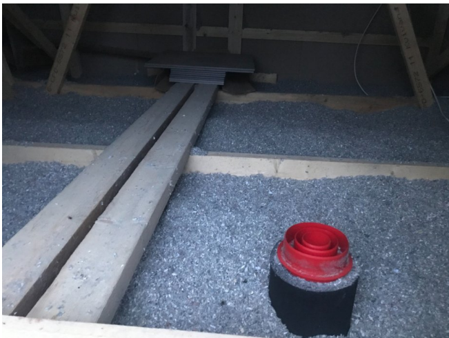
Radon-putkea ei ole yhdistetty katolle asti
