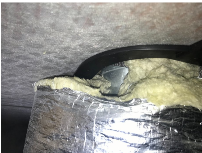
IV-putken eristys ei yllä loppuun asti. Pinnalle voi kerääntyä kondenssivettä
